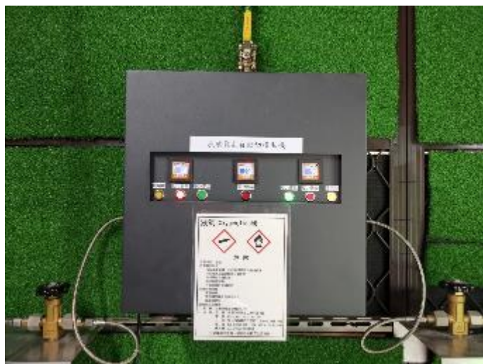
氣體切換主機設備
