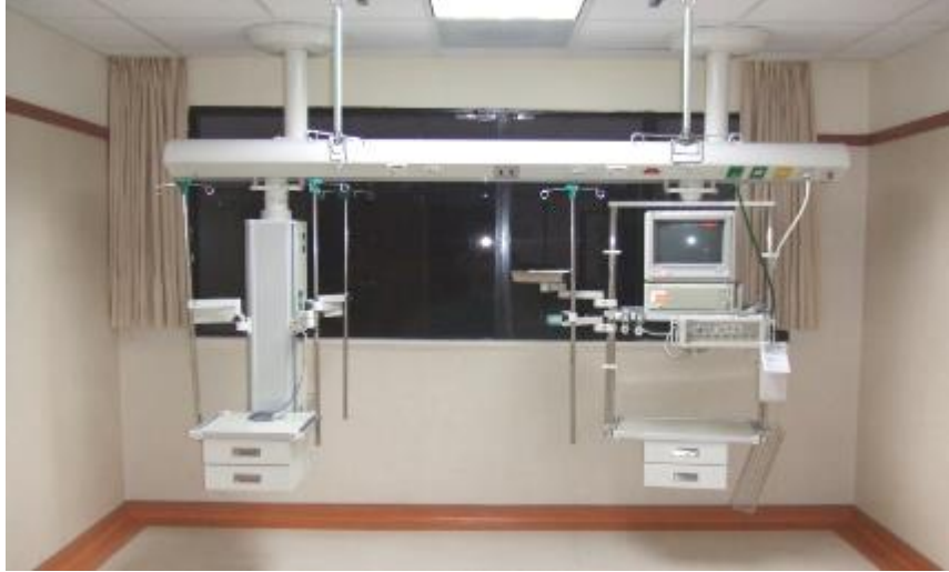
加護病房氣體橋式吊塔
