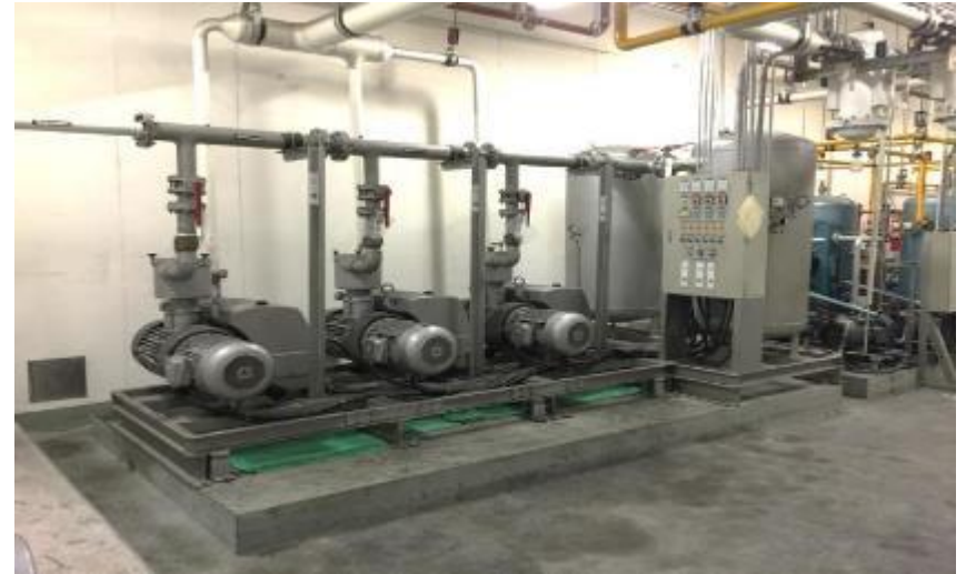
真空泵主機設備
