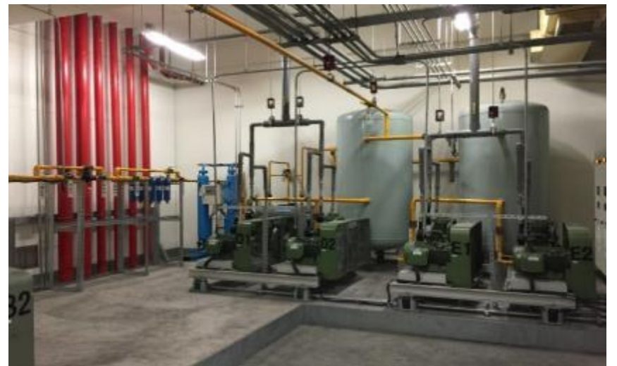
空氣壓縮主機設備
