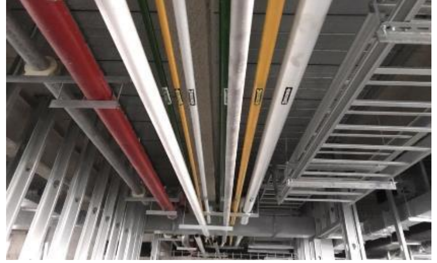
醫療氣體配管管路標示
