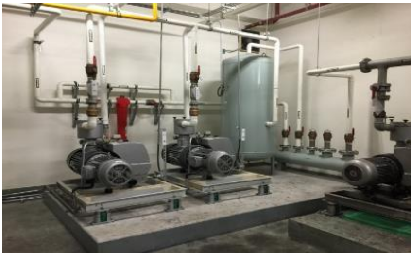
真空泵主機設備
