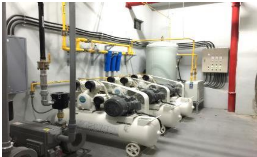
空氣壓縮主機設備
