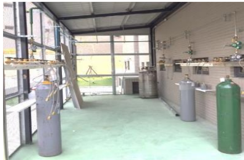
小液態鋼瓶主機設備
