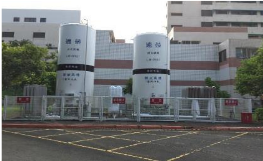
液態氧儲槽設備
